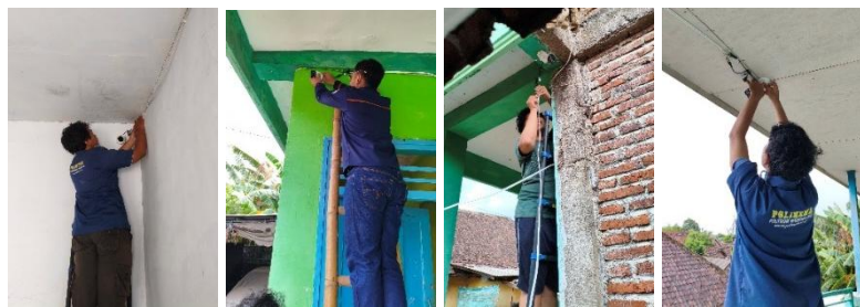
Gambar 2. Titik pemasangan kamera CCTV
